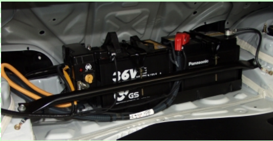
クラウンマイルドハイブリッドに搭載された36Vバッテリー。メーカーでは3年毎の定期交換基準を設けている。ちなみに補修用の価格は4万円だ。
